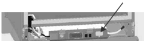
JUNTA DEL RCCB
